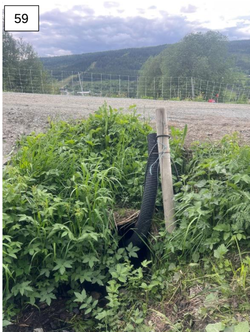
Innløp stikkrenne 400mm. Ligger også 110mm drenerør gjennom røret som begrenser kapasitet og gjør at det lettere tettes. Anbefales fjernet. Fare for vann på avveie mot vest
