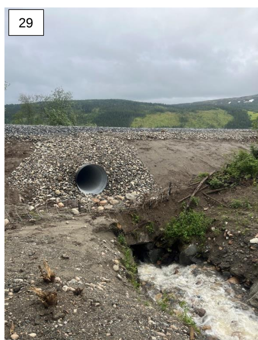
Innløp stikkrenne 500x1000mm og flomløp 1400mm under jernbanen. Flomløp 1400mm høyere i jernbanefylling anlagt av Bane NOR i perioden 08.-10. juni 2024
