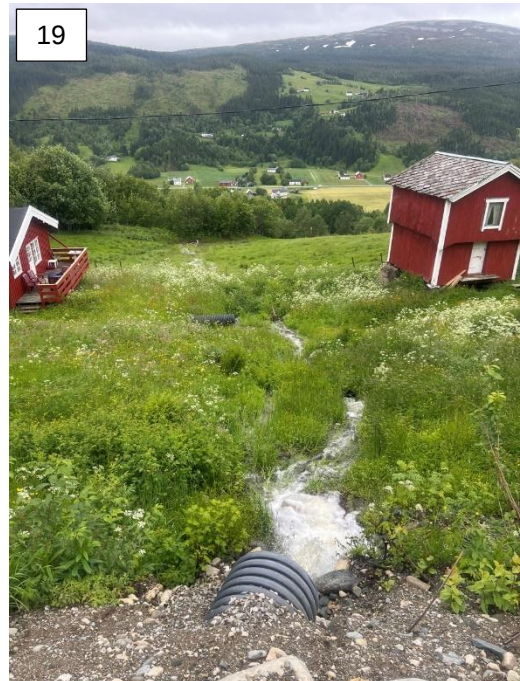
Utløp stikkrenne 600mm under veg. Bekk går ut på jorden ned mot jernbanen.
