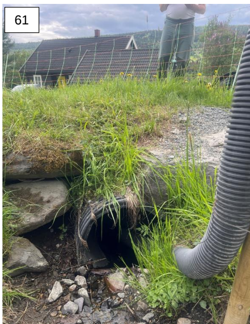
Innløp stikkrenne 500mm under veg. Noe gjentetting av masser og 110mm drenerør gjennom røret begrenser kapasitet. Fare for gjentetting. Anbefaler at røret fjernes
