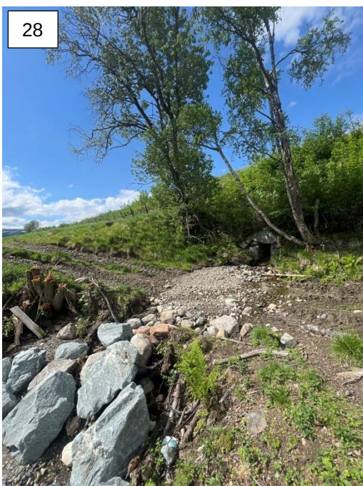
Utløp stikkrenne 500x1000mm under jernbanen. Landbruksveg krysser bekken rett etter utløpet. Ingen erosjonssikring. Flomløp 1400mm høyere i jernbanefylling anlagt av Bane NOR i perioden 08.-10. juni 2024
