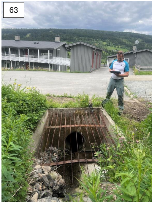
Inntak bekkelukking 500mm. Bekkelukking under bebyggelse nedstrøms. Sårbart
