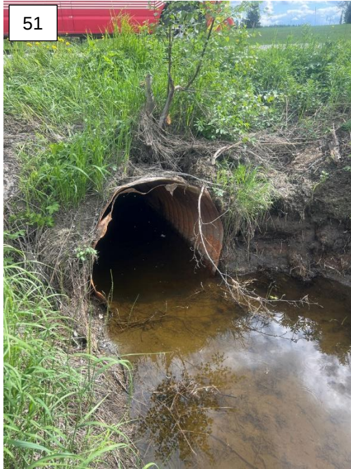
Utløp stikkrenne 1200mm. Rustet og kollapset i innløp, anbefales å utskiftes
