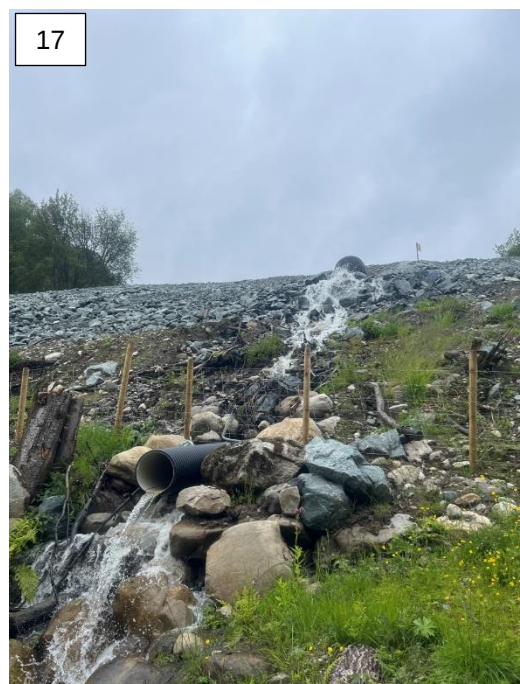
Utløp stikkrenne 1000mm under jernbanen. Etablert etter flomhendelse 2023. Bør ledes inn på eksisterende bekkeløp. Rør 400mm i bunn for drenering av fylling
