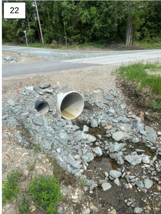
Utløp stikkrenner 1000mm og 400mm under fylkesveg. Dårlig/ingen erosjonssikring
