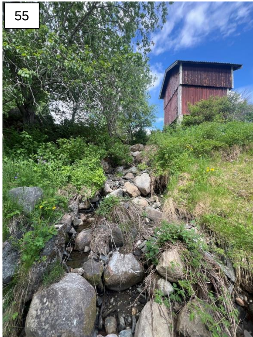
Noe erosjon i bekken, og fare for vann på avveie ved flatere helning der hvor bildet er tatt
