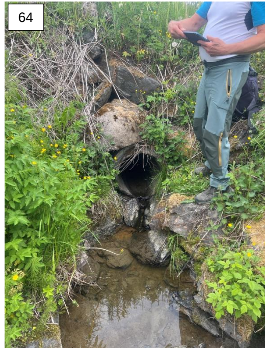
Utløp bekkelukking 500mm
