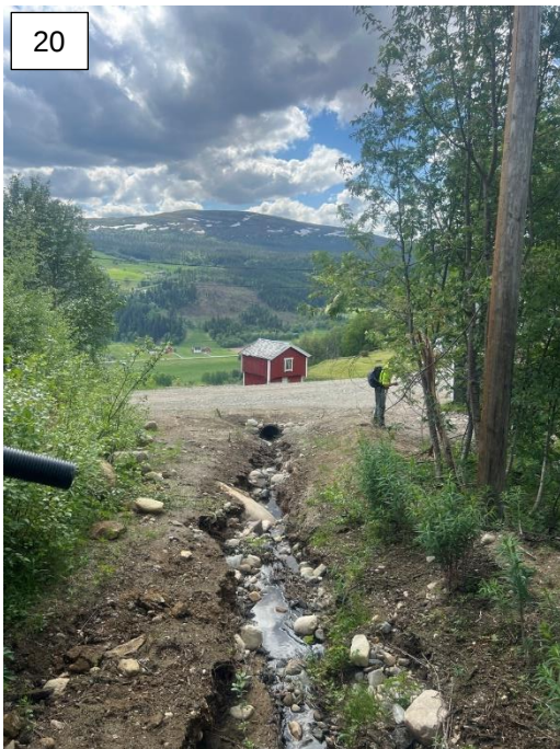
Innløp stikkrenne 600mm under veg. Mye erosjon i bekkeløp og fare for gjentetting.
