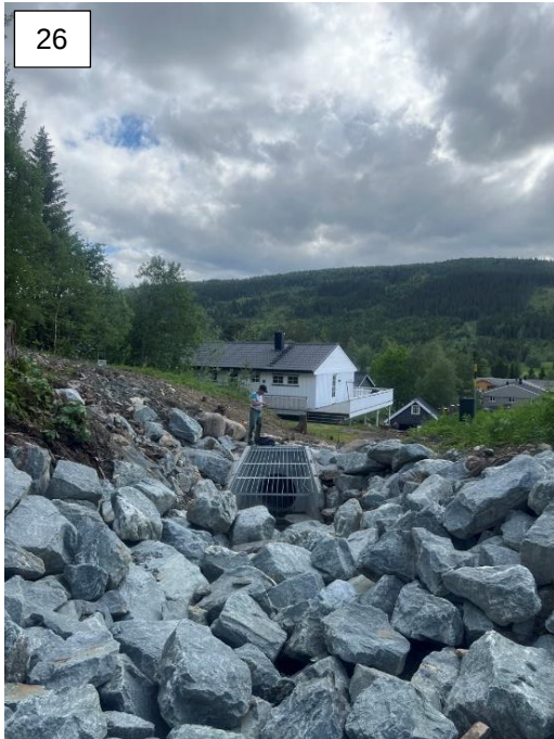
Inntak stikkrenne 1200mm med gitter. Stor fare for gjentetting og vann på avveie i boligfelt nedstrøms
