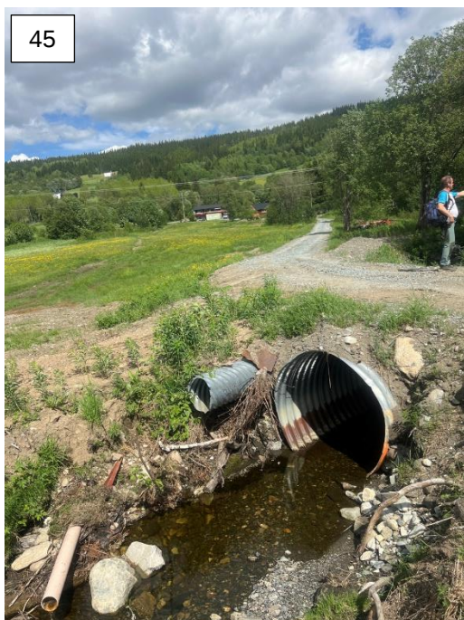
Utløp stikkrenner 1400mm og 400mm. Mye finsediment i bekken
