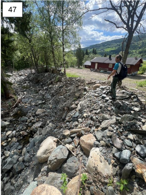
Mangelfull erosjonssikring i yttersving oppstrøms bolighus. Veldig sårbart og fare for vann på avveie mot bolig.
