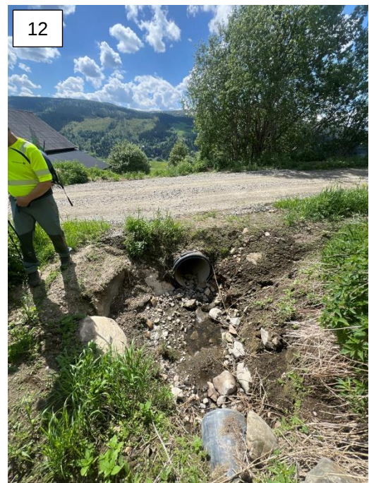
Utløp stikkrenne 300mm og innløp stikkrenne 600mm under Bakkavegen
