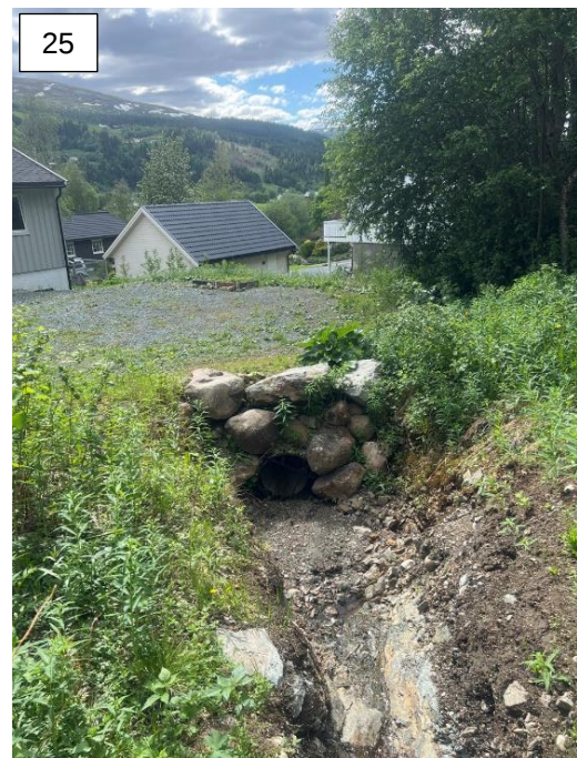
Innløp stikkrenne 600mm. Gitter foran, fare for gjentetting. Gitter anbefales fjernet
