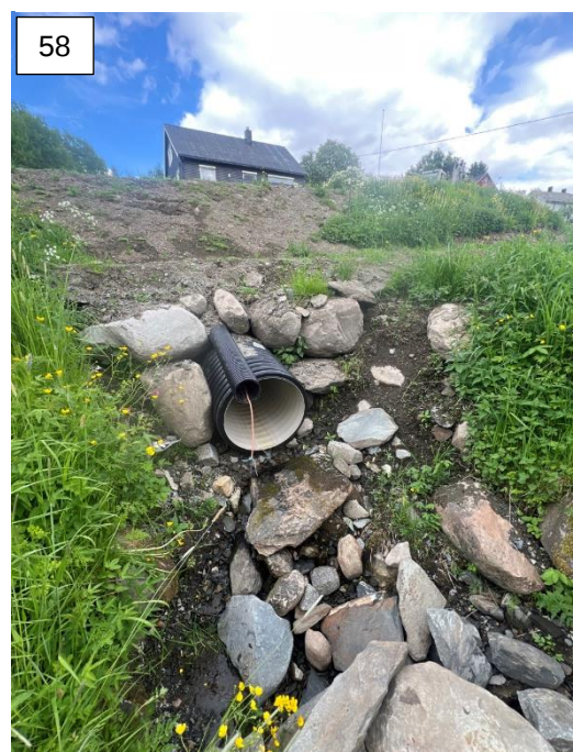
Utløp stikkrenne 600mm. Manglende erosjonssikring
