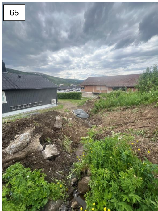
Svært mangelfull erosjonssikring i forkant av ny inntakskonstruksjon
