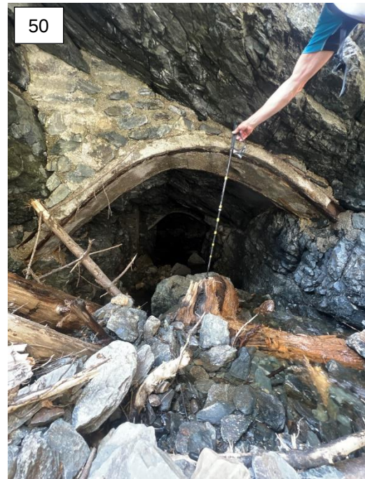
Innløp kulvert under jernbanen. Ca. halv dimensjon og betydelig mindre kapasitet enn opprinnelig grunnet tilstuvning av masser
