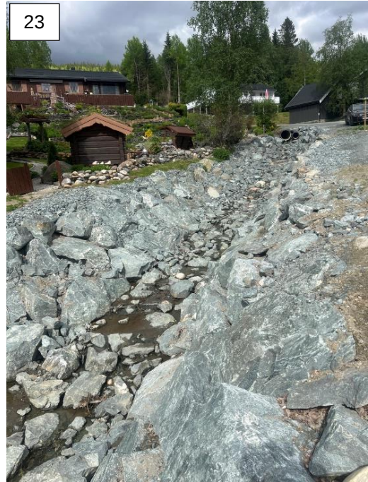
Bekkeløpet ble forsterket etter flomhendelse 2023. For dårlig erosjonssikring
