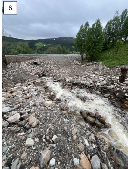
Innløp stikkrenne og flomløp under jernbanen. Stor sannsynlighet for gjentetting stikkrenne ved flomhendelse. Flomløp anlagt av Bane NOR i perioden 08.-10. juni 2024
