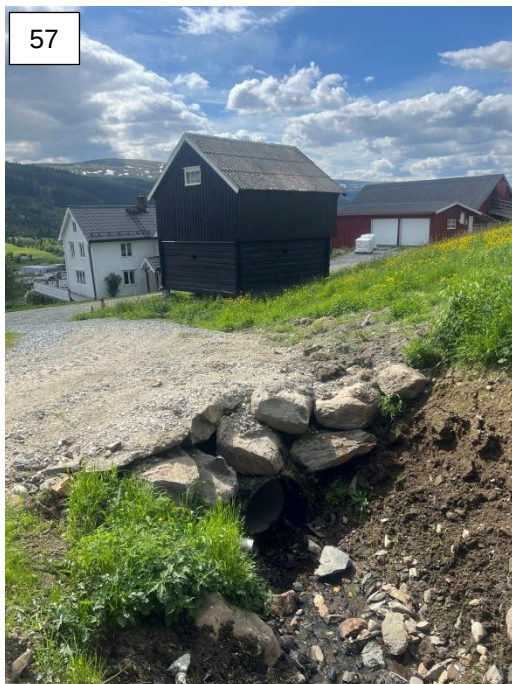
Innløp stikkrenne 600mm. Manglende erosjonssikring og fare for å flomme over veg og utvasking ved flomhendelse
