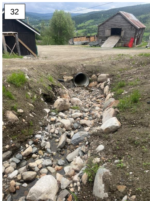
Foran innløp stikkrenne 1000mm. Mangelfull erosjonssikring. Fare for gjentetting
