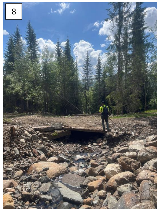
Platebru av jernbanesviller. Masser fra flomhendelser 2023 gjør at lysåpning under bru er sterkt redusert
