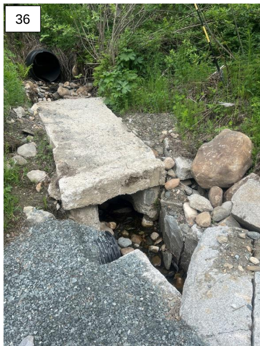
Utløp stikkrenne 800mm under veg i forkant av innløp stenkanal under vegkulvert. Svært sårbart
