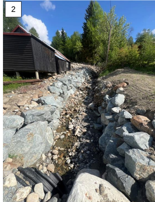
Innløp stikkrenne 1200mm under adkomstveg gårdsbruk. Mangelfull erosjonssikring
