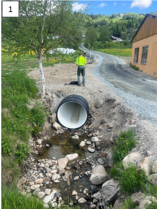
Utløp stikkrenne 1200mm under adkomstveg til landbruk
