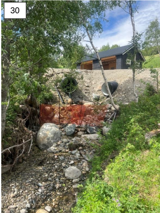
Utløp 2 stk stikkrenner 1000mm under veg. Gjerde og masser rett ved utløpene. Mangelfull erosjonssikring
