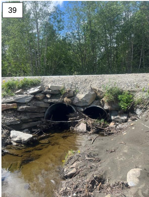
Innløp stikkrenner 1200mm og 1000mm. Rustet og i dårlig stand, kan kollapse. Dykket, med mye sediment og avfall foran innløp.
