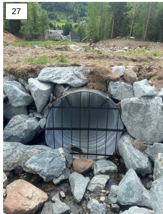
Innløp stikkrenne 1200mm med gitter. Stor fare for gjentetting og kollaps av kryssing ved flomhendelse. Gitter anbefales fjernet
