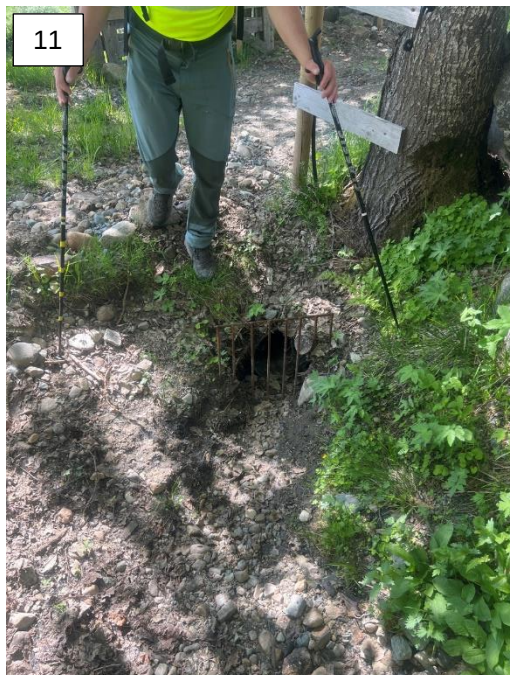
Innløp stikkrenne 300mm ned til Bakkavegen. Rist foran innløp, stor fare for gjentetting
