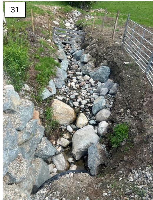
Foran innløp stikkrenne 1000mm. Mangelfull erosjonssikring, og dårlig utforming av innløp. Fare for gjentetting.
