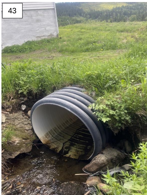
Innløp stikkrenne 1000mm
