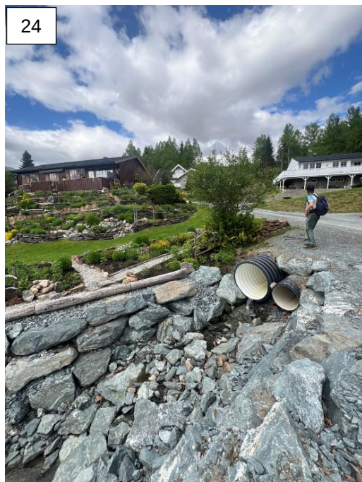
Utløp stikkrenner 1000mm og 600mm. For dårlig erosjonssikring
