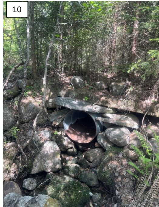
Utløp stikkrenne 500mm utløp under gammel og gjengrodd landbruksvei. Mye hogstavfall ved innløp
