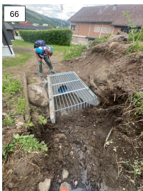
Inntak bekkelukking 600mm. Bekkelukking under parkeringsplass/bebyggelse ut mot sentrum. Svært sårbar for utvasking rundt inntak og gjentetting. Ikke erosjonssikret
