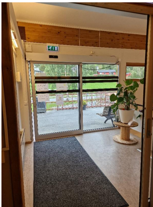
Figur 6: Defekt åpne-/lukkemekanisme på ytterdøren i 2.etasje.
