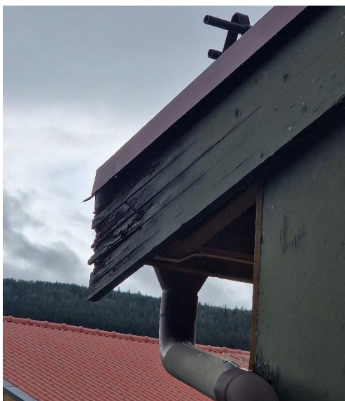
Figur 8: Råte i vindski, fasade øst.
