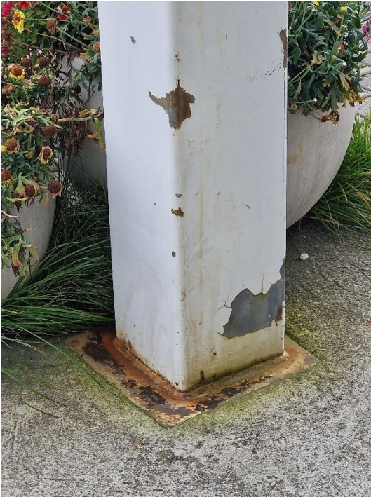
Figur 7: Avskalling av overflatebehandling og gryende korrosjon på stålsøyle.
