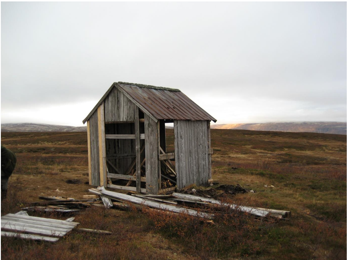
Torvhuset ved Svenuken ble tatt av vinden og eksisterer ikke lengre.
